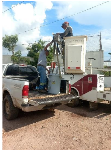
Gestión de transformador para la colonia Lindavista 2
